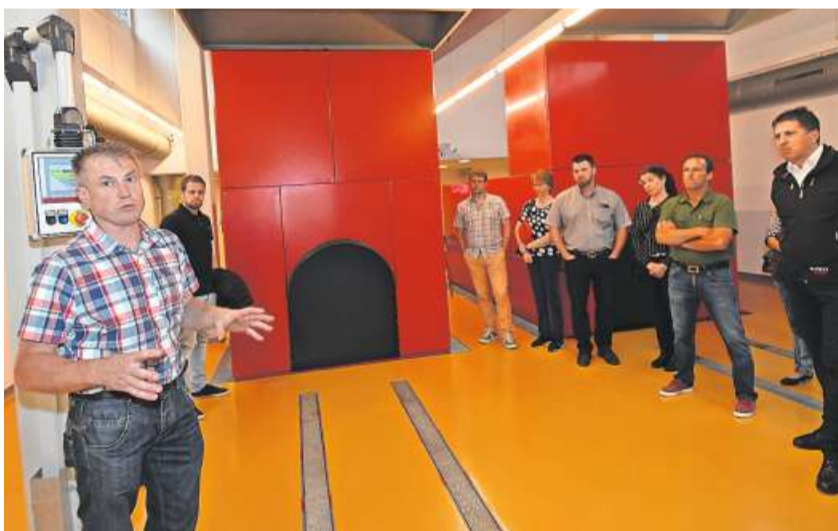
Betriebsleiter Erwin Auf der Maur (links) stellte gestern den neuen Ofen im Krematorium Schwyz in Seewen vor. Bild: Andreas Seeholzer
